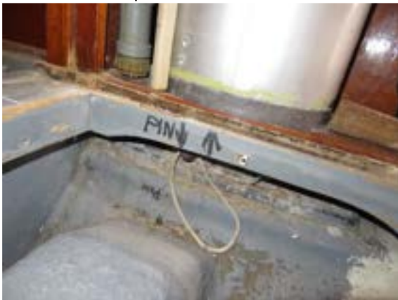
Mast keel step intact
